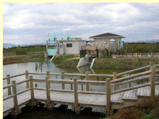
反復利用のための揚水機場と調整池
