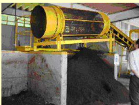
堆肥プラント
